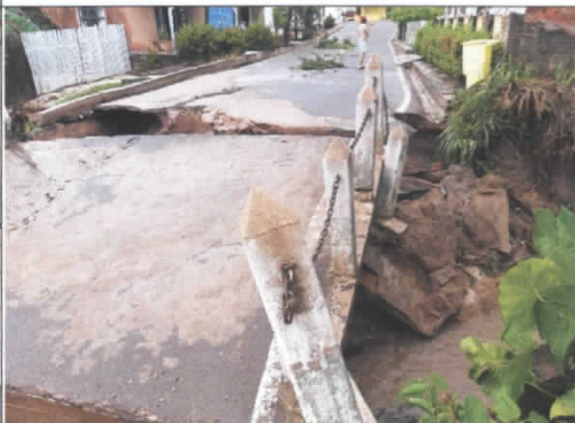
Foto 04 – Estrutura da ponte abalada
