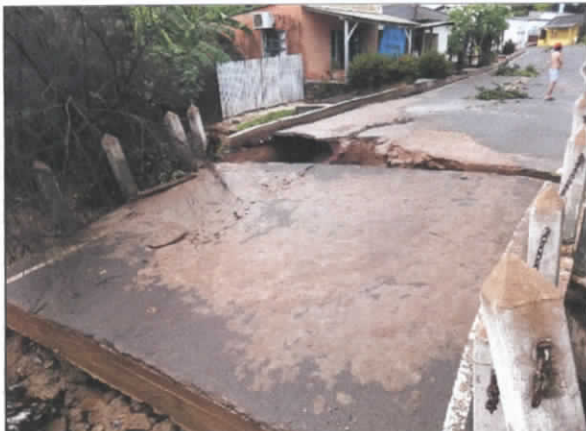
Foto 01 – Ponte do Surubejú, com sua estrutura completamente comprometida
