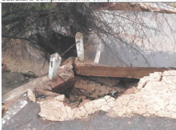
Foto 03 – Cabeceira da ponte desmoronou devido a forte chuva
