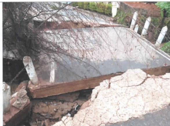
Foto 02 – Detalhe do tabuleiro danificado
