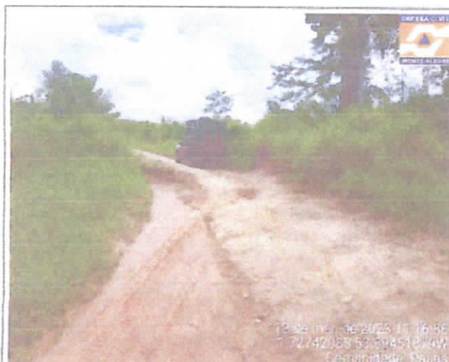
Uma fissura na Comunidade de Pacas
