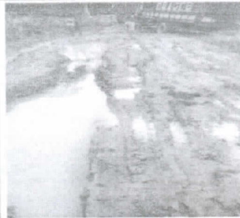
Trecho crítico no setor 15.
