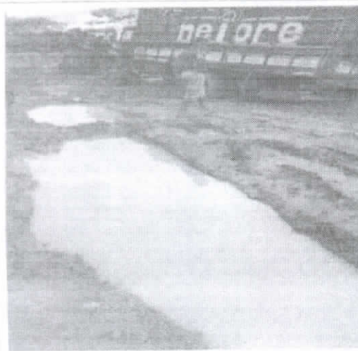
Atoleiro grande no Setor 15 da PA 254
